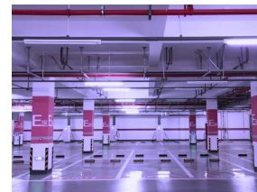
照明 模式切换、A区单号车位 控制、A区双号车位控制、 A区单号车道控制等。
