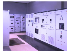
配电机房 电压、电流、有功功率、 无功功率、视在功率、 正向无功总电能等。
